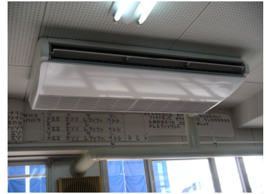
＜教室に設置されたエアコン＞
